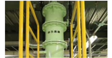
砂ろ過器 処理水中のSSを砂ろ過器にてろ過し、さらに良質な水質にします。
