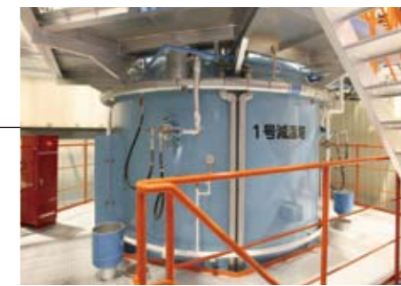
減温塔 高温の燃焼ガスを自動制御の水噴霧により、急速に冷却します。
