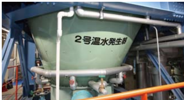
温水発生装置
