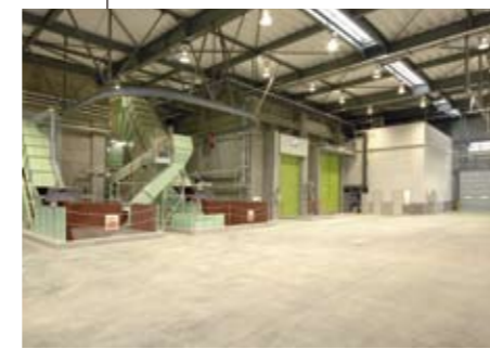
プラットフォーム 施設へ運びこまれたごみを、ここから投入扉を通してごみピットに投入します。
