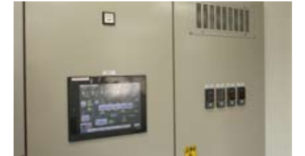
監視設備 水質の管理や機器の状態を確認します。
