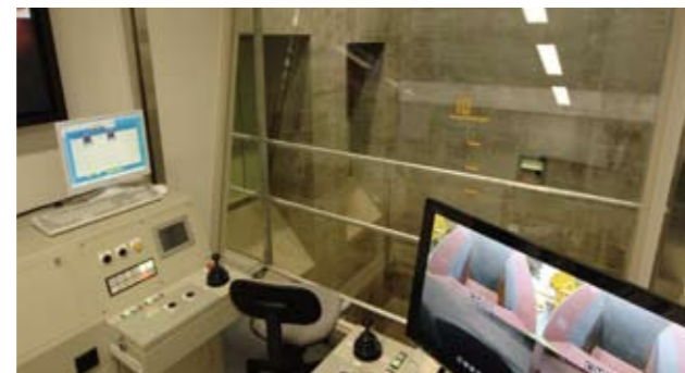
ごみクレーン操作盤
