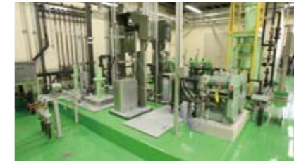
凝集沈殿処理設備 浸出水中に含まれる重金属類やSSを沈殿分離除去します。
