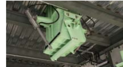
脱水汚泥貯留装置 分離した脱水汚泥は、脱水汚泥貯留装置に貯留後、定期的に搬出します。
