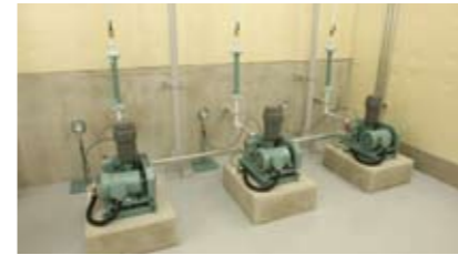
流入調整設備 ブロウ空気による空気攪拌を行い、浸出水の腐敗防止を図るとともに、水質の均一化を図ります。
