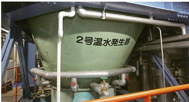
温水発生装置
