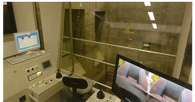
ごみクレーン操作盤
